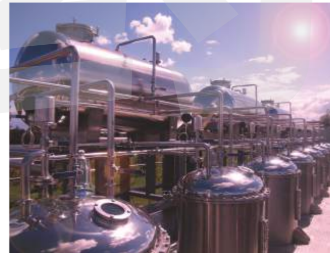
丹麦大孔树脂吸附机组 Denmark Resin Absorbing Unit
