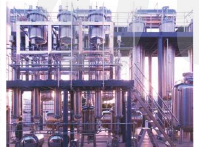
丹麦大孔树脂吸附机组 Denmark Resin Absorbing Unit
