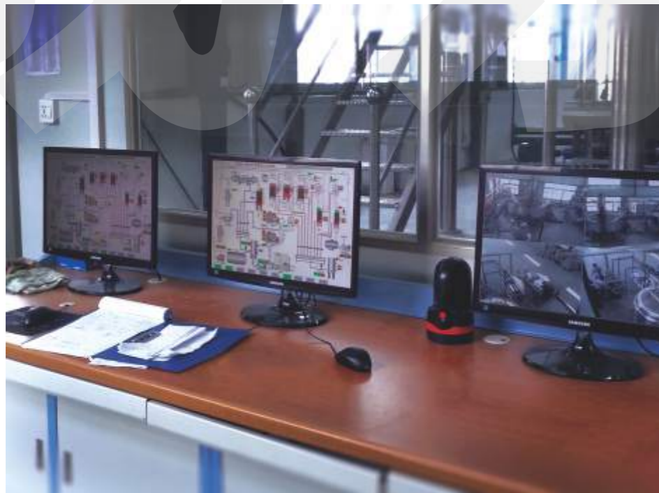
超临界中央控制室 Co 2 Central Control Room
